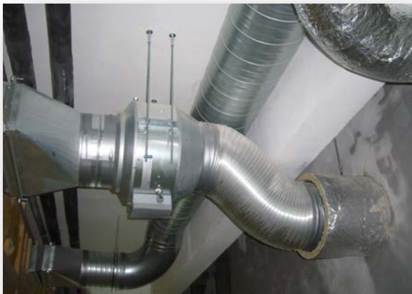
Emergency air fan
